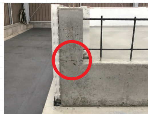
打ち継ぎによるジョイント部
